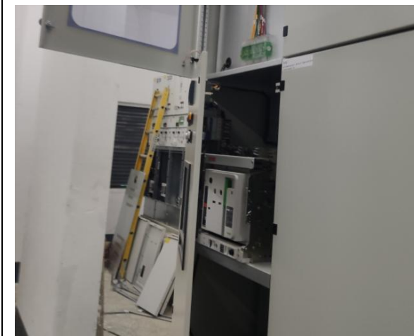
配电设备单独设置在室内（暂未运行）
