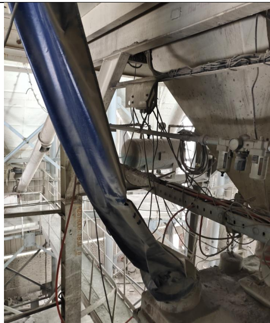
1#生产线搅拌机排气筒进口不具备监测条件
