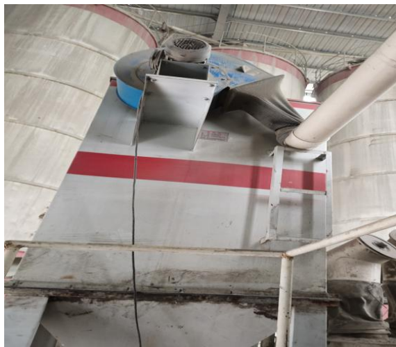
1#线搅拌机除尘设施
