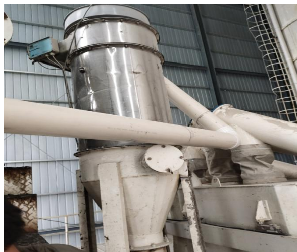
2#线搅拌机除尘设施
