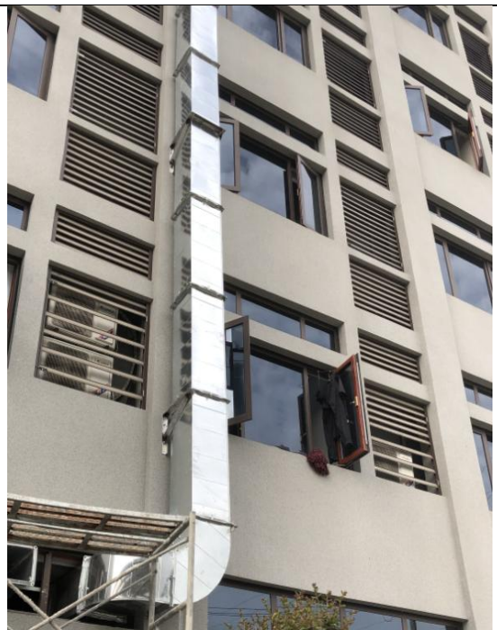
出口管道外观
